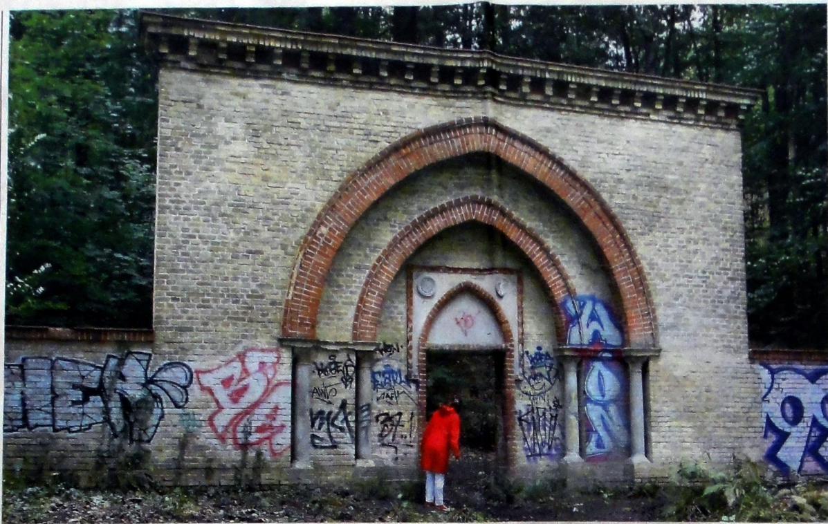
Besprüht und beschädigt. Das Portal der Marienquelle an der Templiner Straße ist seit mehr als zehn Jahren nicht gepflegt worden. Jetzt hat Baudenkmalpfleger Roland Schulze es wiederhergerichtet.
