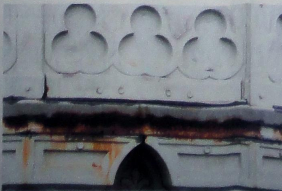
Feuchtigkeit ist das Hauptproblem der Moschee: Sie kriecht unter alles, was nicht dicht am Bau klebt, lässt Bleche und Verschraubungen rosten.
