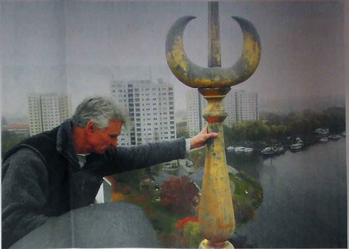
Höher kann der Kran nicht, aber Volker Mattkewitz erreicht, was er erreichen will: Er prüft die Festigkeit des islamischen Dachreiters am Minarett.
