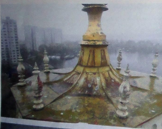
Moos macht sich auf dem obersten Blechdach des Minarettis breit.
