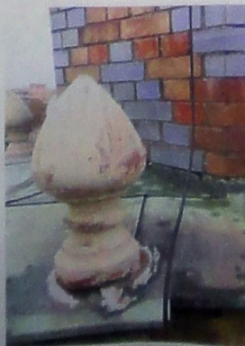
Verwitterte Zapfen-Dichtungen: Einer musste abgenommen werden.
